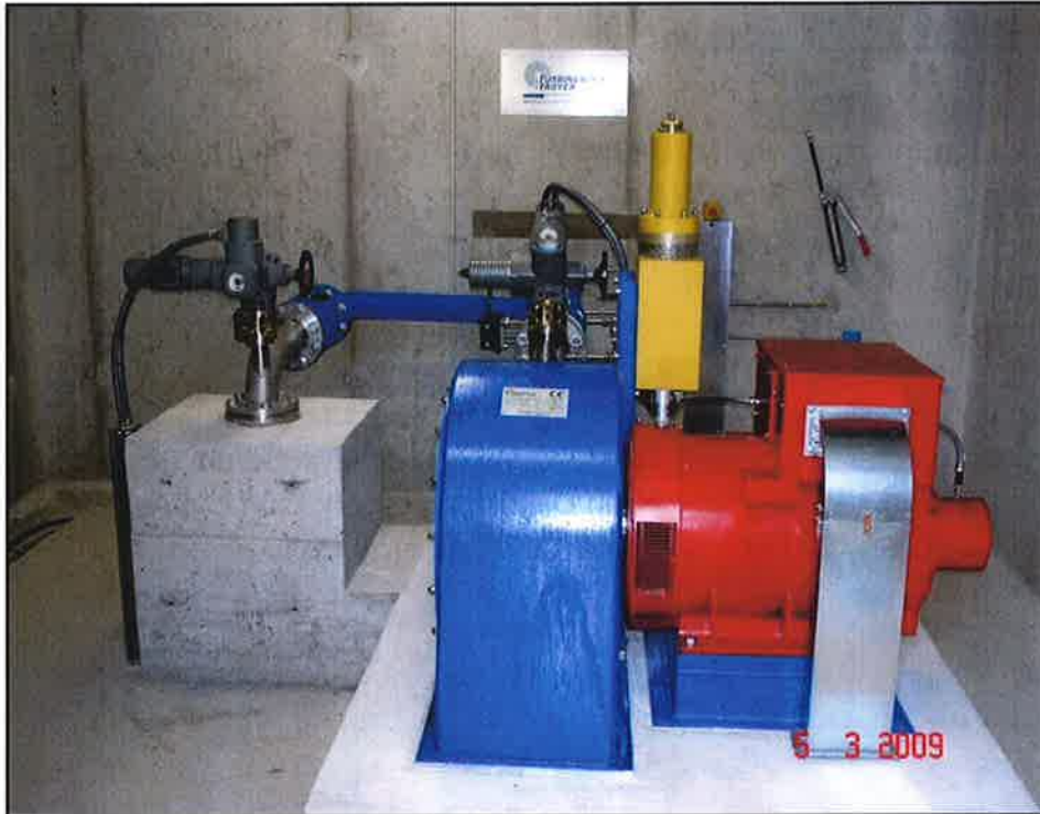
Abb. 3: Turbine (blau) und Generator (rot) der Anlage in Mühlbach/Bramberg
