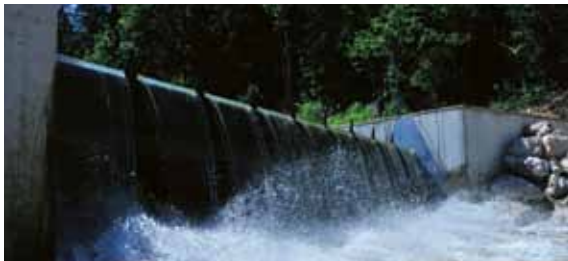
Kleinwasserkraftwerk an der Kainischtraun in Pichl-Kainisch. Foto: ÖBf Archiv/Wolfgang Simlinger
