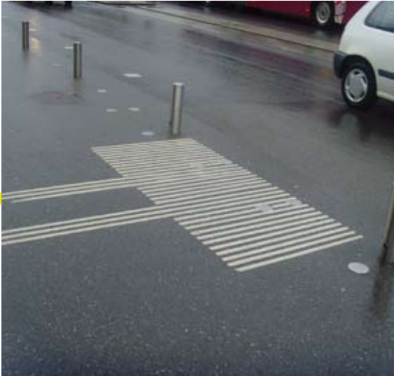
142 Taktiles Leitsystem mittels Markierung
