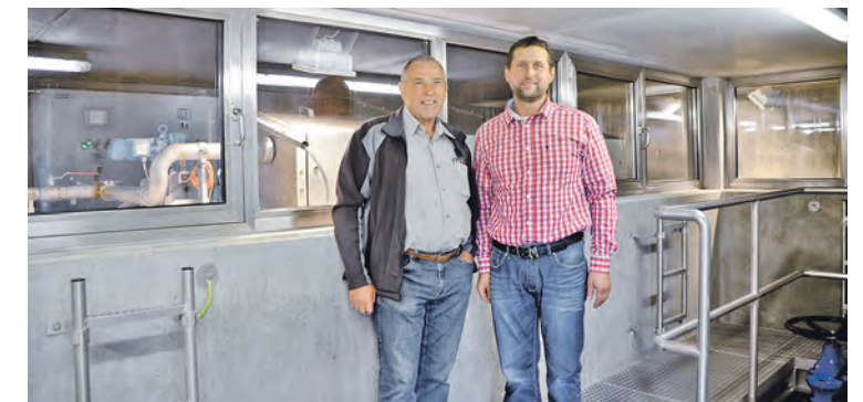
Der frühere Brucker Wassermeister Hans Öttl (l.) und der jetzige Wassermeister-Stellvertreter Martin Lederer im Einlaufbauwerk.
